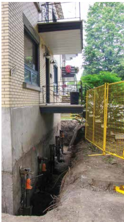
La sécheresse de l'été 2012 a entraîné l'affaissement du sol et causé des lézardes dans plusieurs habitations du sud de la province.
